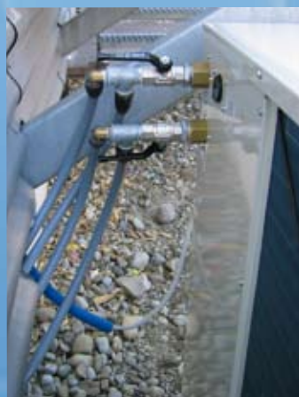
Anschlüsse mit Wasserschläuchen
